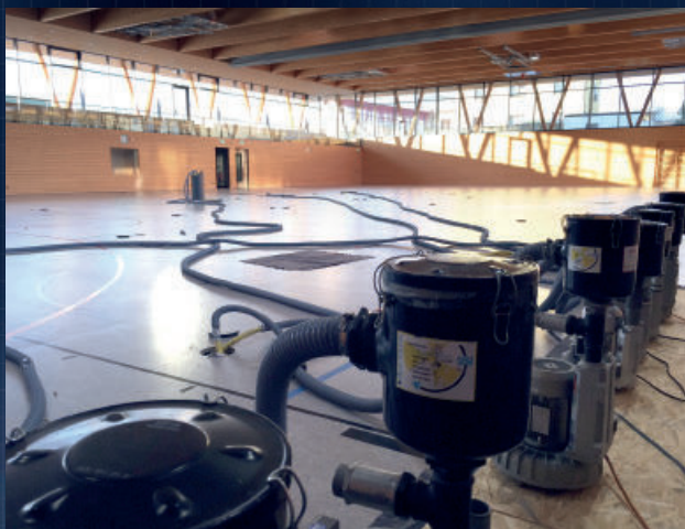
Trocknung im laufendem Betrieb (Turnhalle)
