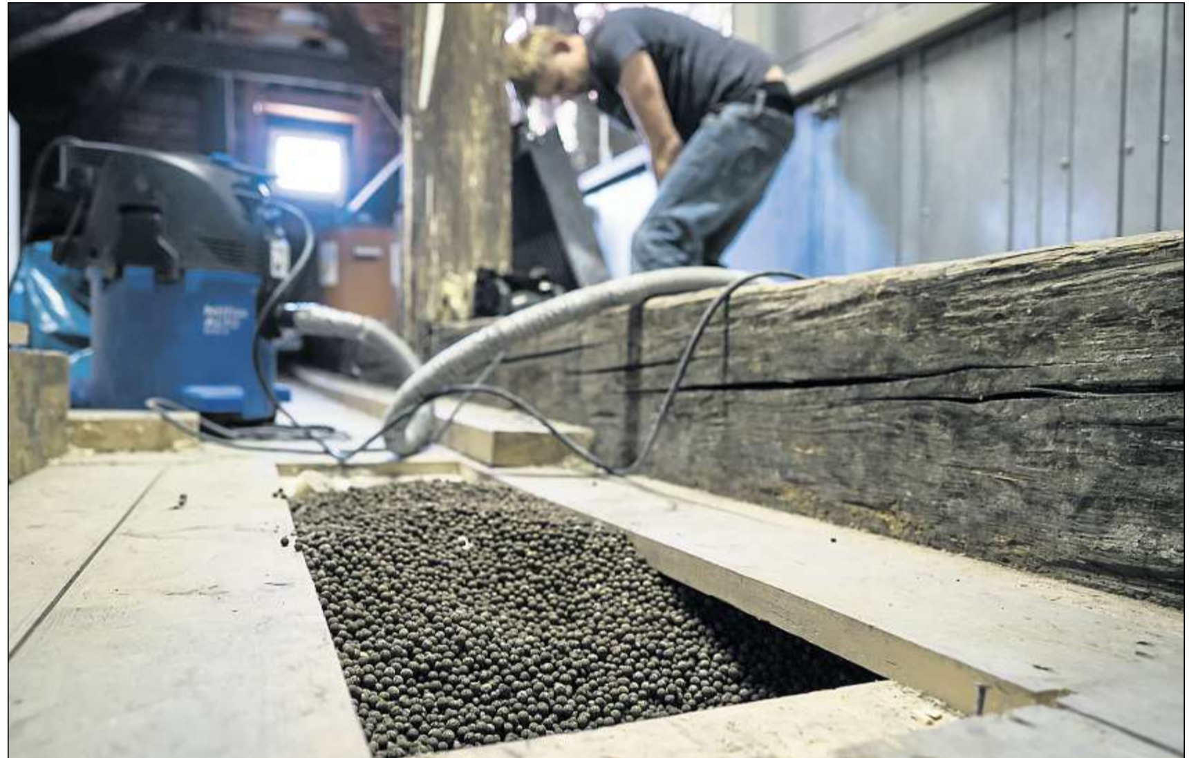
Die Schüttung aus Blähton in den Decken hat die Feuchtigkeit aufgesaugt. Sie muss ebenso getrocknet werden wie die Decken.
