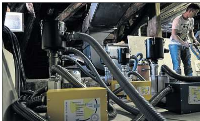
Luft rein, feuchte Luft raus. Klingt einfach. Funktioniert aber nur über ein komplexes System aus Schläuchen und Gebläsen.
