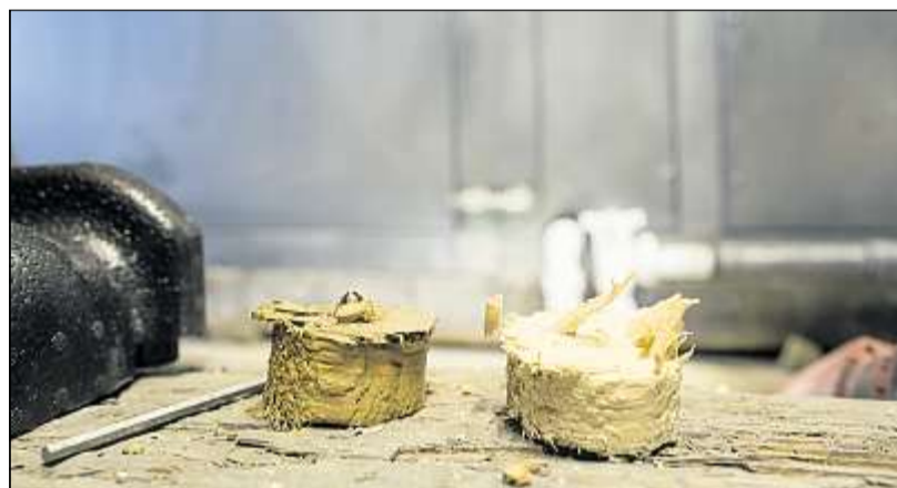
Zwei Bohrkern aus unterschiedlichen Ebenen: Der linke stammt aus der unteren Holzdecke und ist deutlich nasser als der obere, schon angetrocknete.
