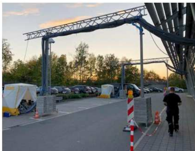
Abb. Auslagerung Trocknungstechnik/Kabelbrücken
